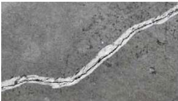
Рисунок 3. V-образная канавка вдоль трещины
